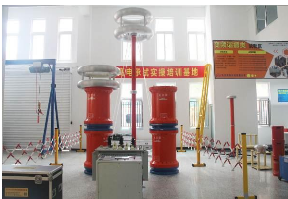
高压谐振类试验场地
